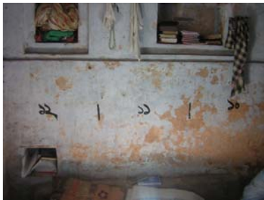
Fig. 31 Moisture on wall
